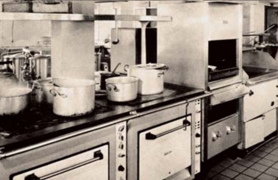
1960年代，有兩個商用廚房使用煤氣服務，上為瑪麗醫院的中式廚房，下為國泰航空預備航膳的廚房
