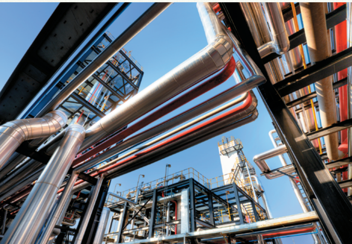
易高位於山西省的先進液化煤層氣廠一直運作順暢
