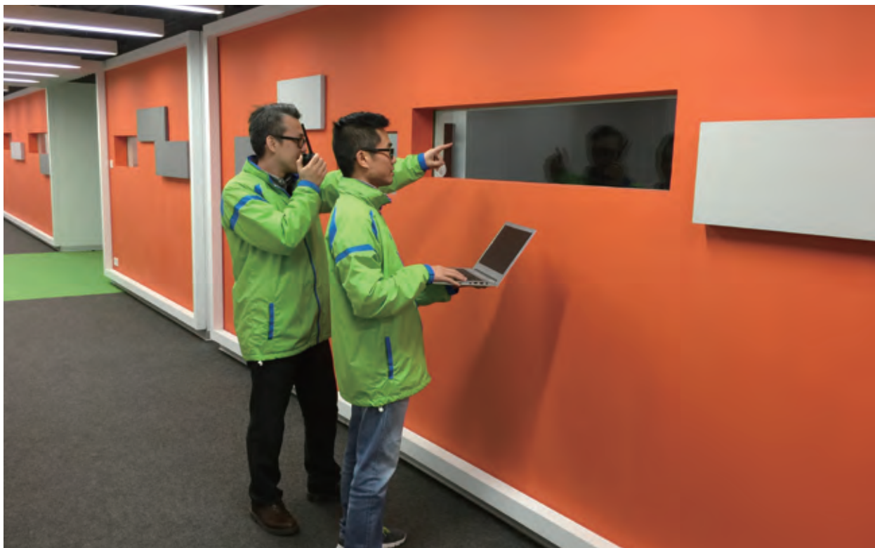
名氣通香港2號數據中心技術工程人員巡檢
