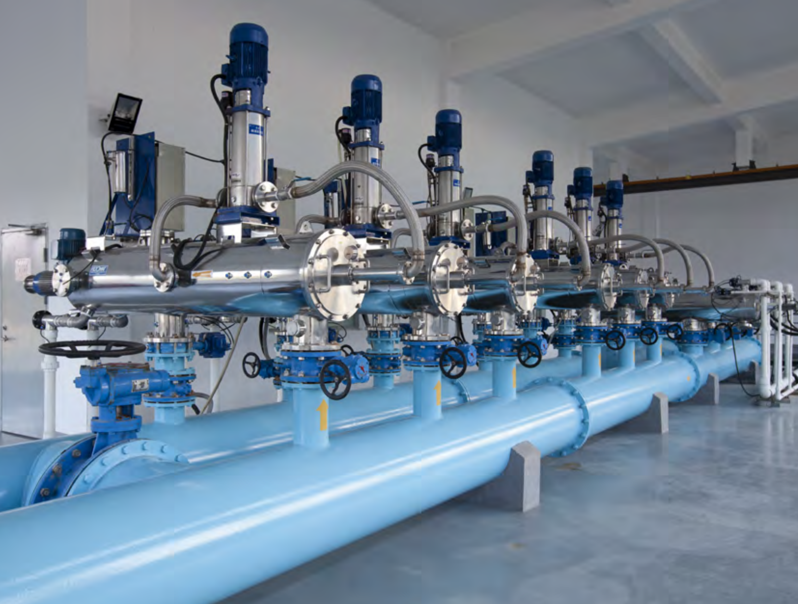
蘇州清源華衍第二污水處理廠中水過濾設備（以色列福特馬特過濾器）
