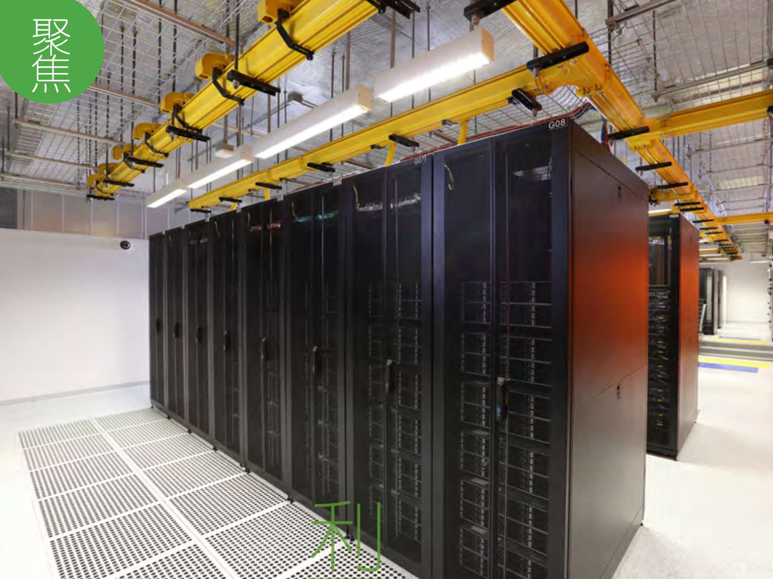
名氣通香港2號數據中心機房
