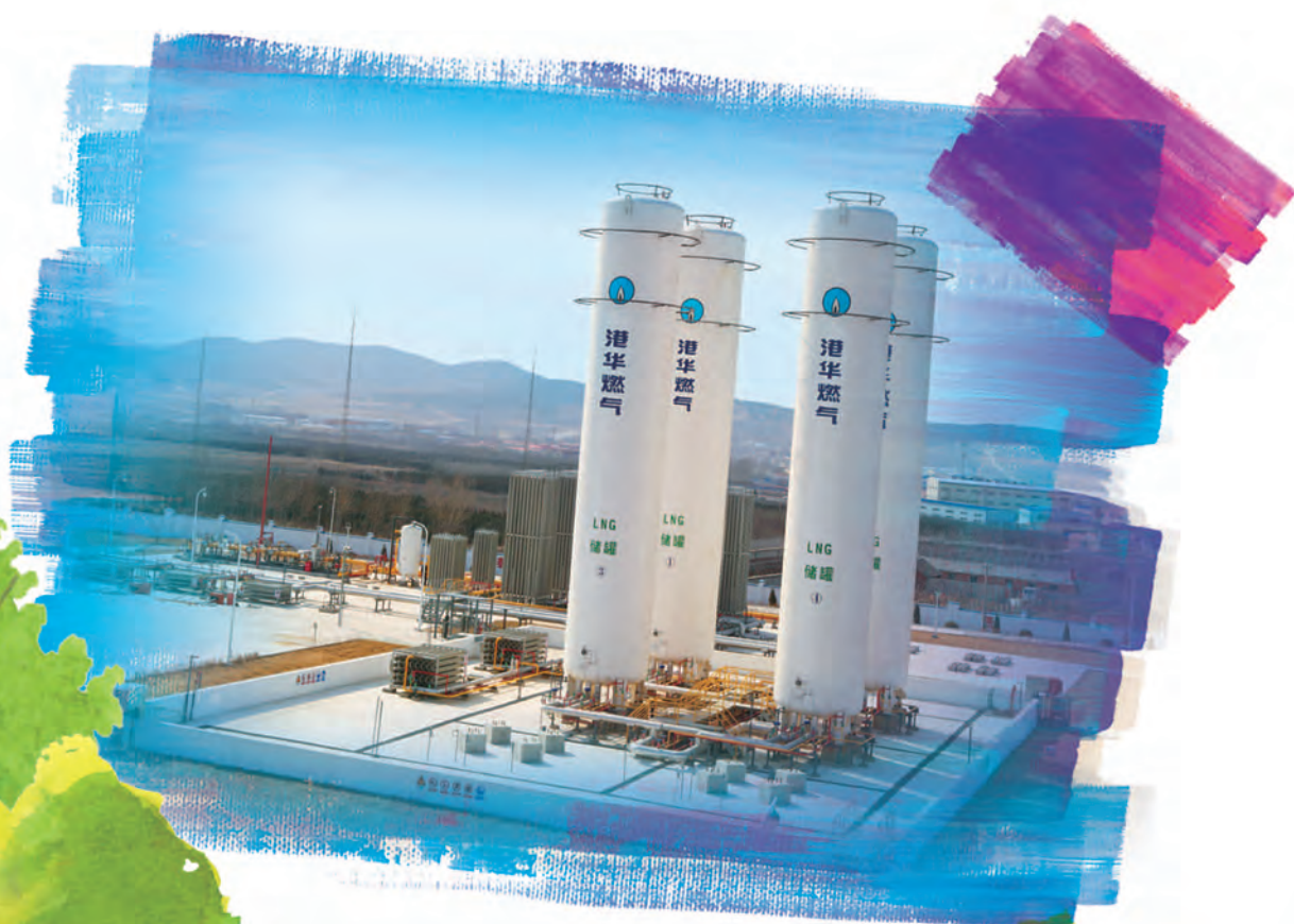
位於大連旅順港華燃氣有限公司之液化天然氣儲罐
