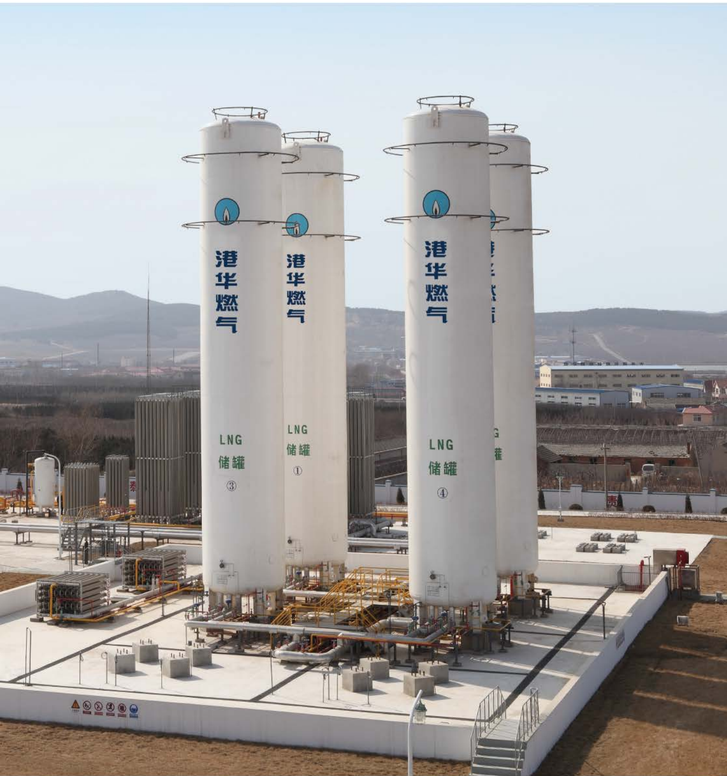
港華建造LNG儲氣站，以LNG作為應急調峰的儲備能源
