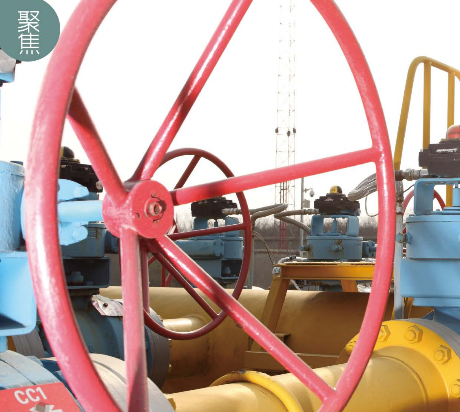
港華工作人員對廠站設備進行檢查維護
