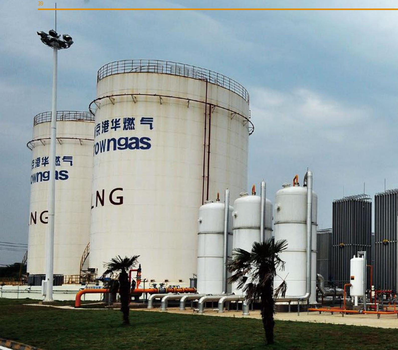
南京港華LNG儲配站
