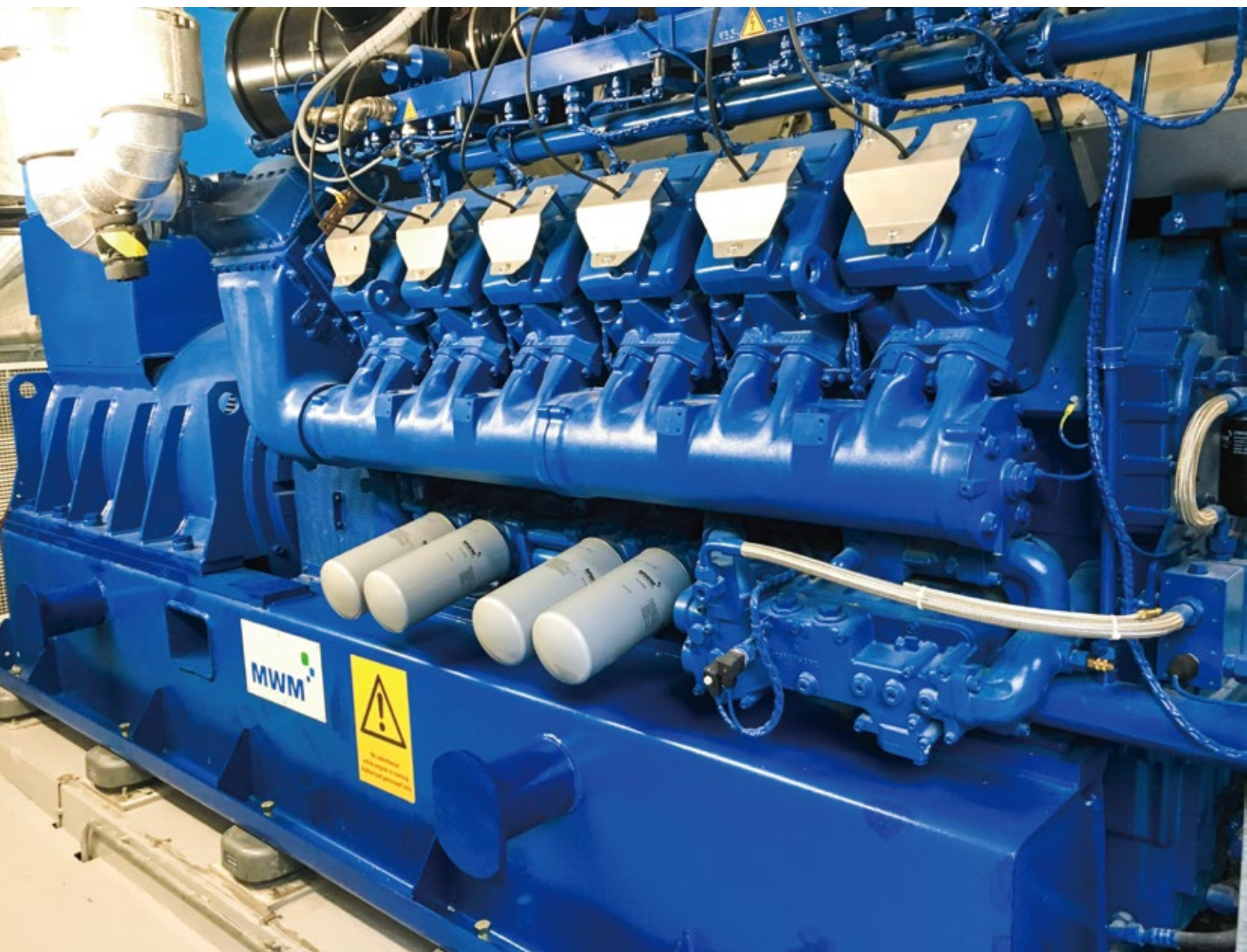
熱電聯供系統以沼氣發電，提供電力及熱能予醫院提高能源效用
