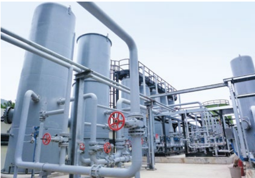
位於新界東南堆填區的沼氣處理項目於2017年投產
