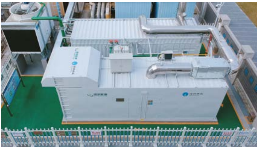
深燃大廈綜合能源項目的設備
