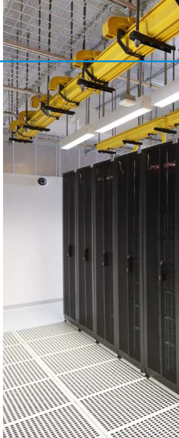
名氣通香港2號數據中心機房
